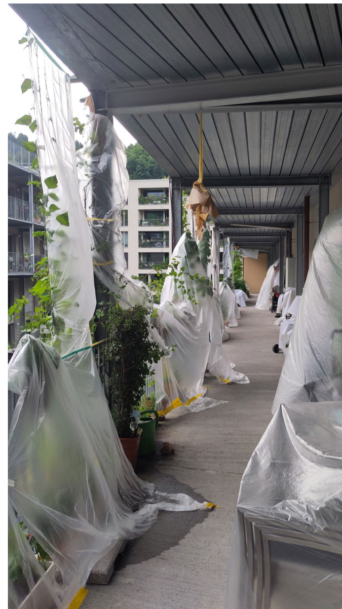
Ist das Kunst am Bau ... oder nur Sanierung auf den Laubengängen?
